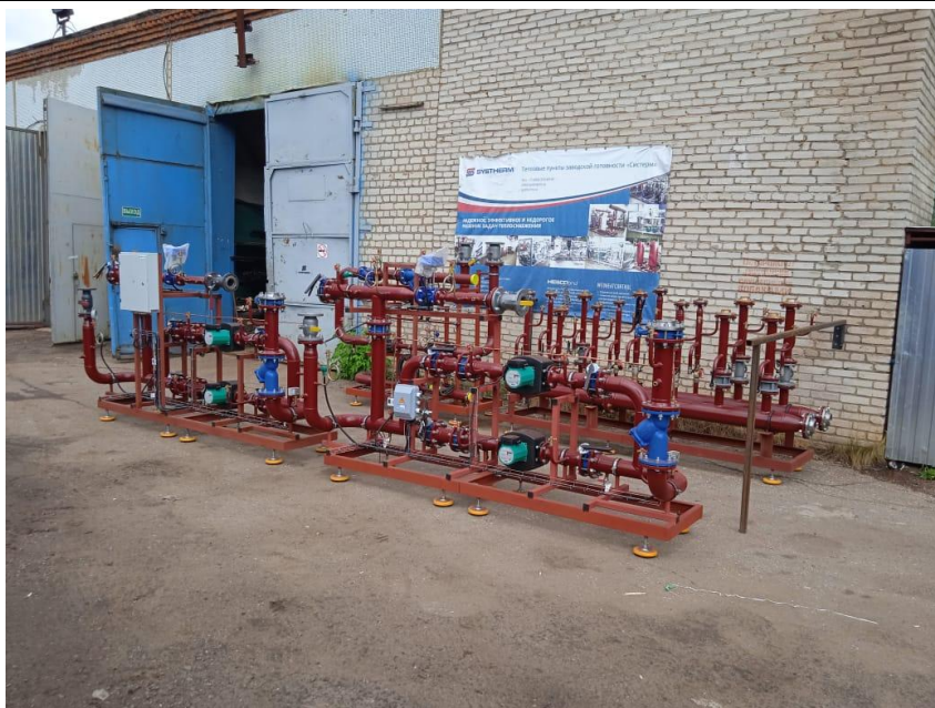
«Нижекамскнефтехим», г.Нижекамск, Поставка БТП системы отопления
